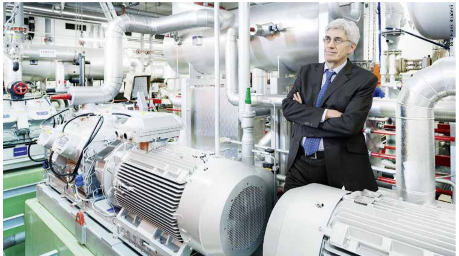
Lorenz Hilty, Delegierter für Nachhaltigkeit an der UZH, inspiziert die neu installierte Kälteanlage am Campus Irchel.
