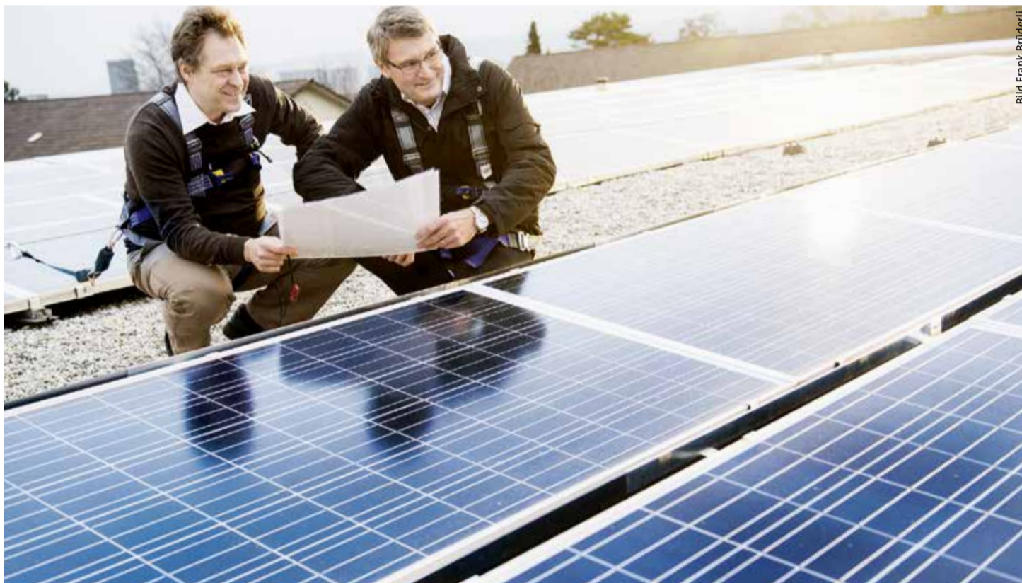
Sven Alberding und Peter Meier von der Fachstelle Gebäudetechnik begutachten die Solarzellenanlage auf dem Dach des Tierspitals.
